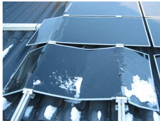
Fehlerhafte Modulbefestigung [Bilder: DGS Berlin]
